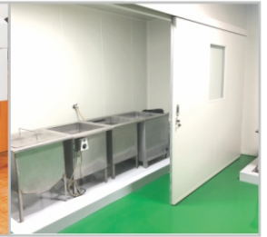
潔淨室禁油清洗設備
